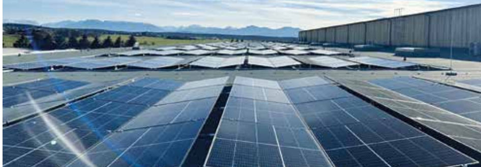
Bild: HK Elektrik
